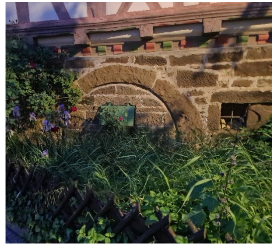
Abbildung 19: Abgebrochener und zugemauerter Kellerhals in Kürnbach als Hinweis auf einen Gewölbekeller
